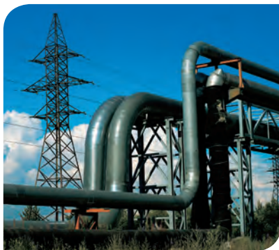
Diaľkový rozvod tepla
